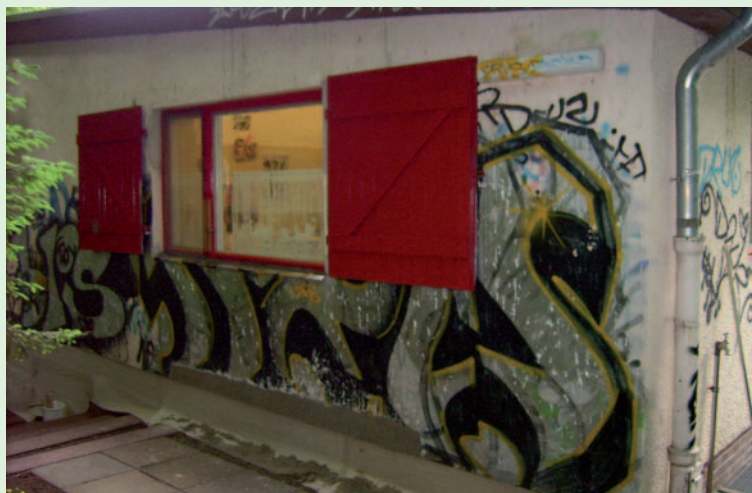
So sah die Fassade der Kindertagesstätte seit Jahren aus.
