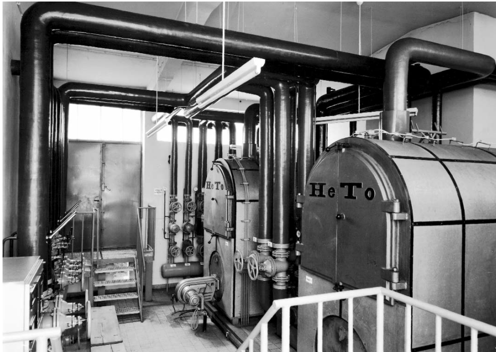
Blick in den Heizungsraum; 1963
